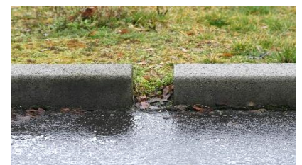
Damit Regenwasser in der Grünanlage versickern kann, wurden hier die Randsteine mit größerem Abstand gesetzt
